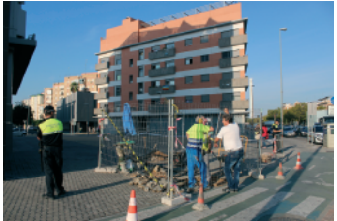
Corte de agua y luz por el Ayuntamiento de Sevilla
